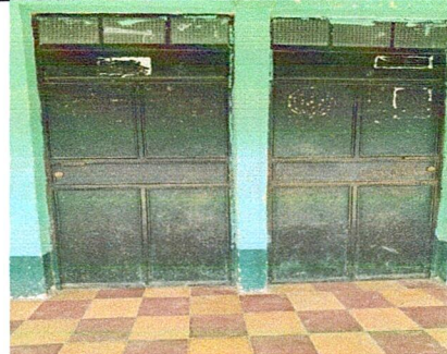
Foto 4: PUERTAS EN MAL ESTADO
