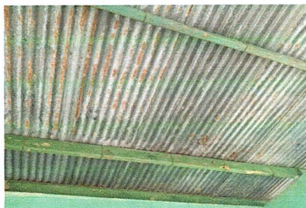
Foto 5: COSTANERAS EN MAL ESTADO
